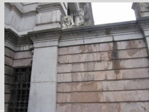
Manchas de humedad
